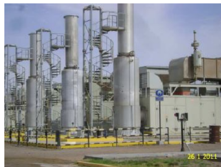
PLANTA PISCO: Vista de tres de los cinco turbo generadores existentes. Enero 2011.
