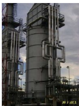
PLANTA MALVINAS: Vista general del Horno de Hot Oil EAP-15850, en cuya primera plataforma se encuentra la válvula TSV-15850-A cuya ubicación está señalada con flecha. Marzo 2011.
