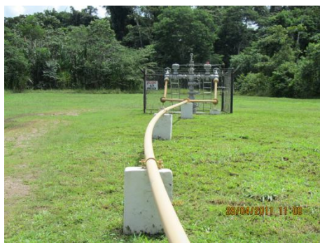
Lote 31 C: La tubería está identificada (pintada), de acuerdo al código de colores de la NTP399.012. Abril 2011.
