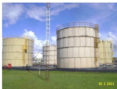
PLANTA MALVINAS: Vista de área de los 04 tanques de almacenamiento de turbo y diesel-2, los mismos que se encuentran dentro de un área estanca. Marzo 2011.
