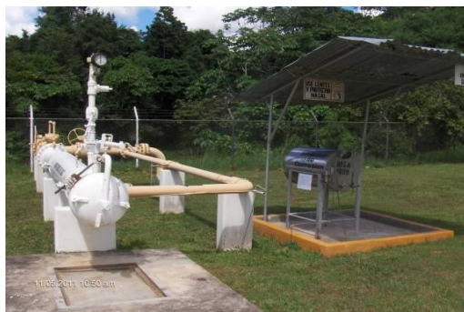
Aguaytia Energy: Trampa de lanzamiento de Raspatubos en línea de GN de 12", nótese sistema de inyección de inhibidor de corrosión. Junio 2011.
