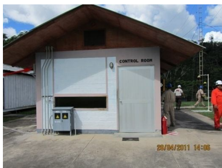
PLANTA CURIMANA: Vista frontal de la Sala de Control. Cuenta con 01 puerta de aluminio, 01 ventana y no está presurizada. Cuenta con equipo de aire acondicionado ubicado en las paredes laterales. Sobre el techo no hay ningún equipo ni tubería de hidrocarburos. Abril 2011.
