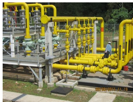
Plataforma Cashiriari 1. Vista de área de manifold. Las tuberías identificadas y con flechas indicando la dirección del flujo. Enero 2011.
