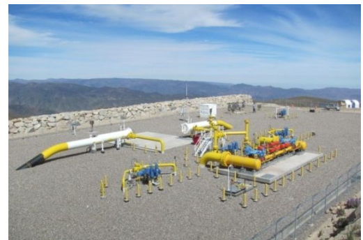
Perú LNG: Vista panorámica del interior de la PCS de Huaytará. Junio 2011.
