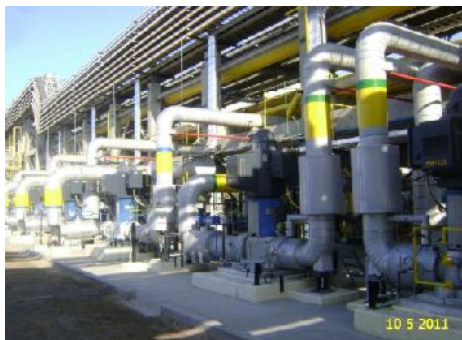
PLANTA PISCO: Vista de Batería de bombas de despacho de propano y butano, sus líneas de succión y descarga se encuentran con aislamientos térmicos limpios y debidamente identificados con pintura. Amarillo verde para el butano y amarillo azul para el propano. Mayo 2011.
