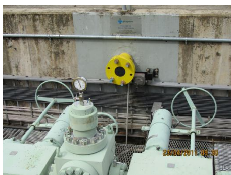
Plataforma Pagoreni B: Vista de pozo 1002, se observa indicador de presión, tuberías, válvulas e instrumentación. SE observa que la integridad mecánica de los mismos es satisfactoria. Abril 2011.
