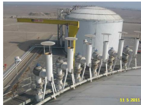
PLANTA PISCO: Vista del domo del tanque TKBJ-13005, se observa la batería de válvulas de seguridad PSV, 06 en total, de las cuales 03 son mixtas, es decir, controlan sobrepresión y vacío. Mayo 2011.
