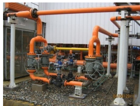
TGP: Vista del estado final de los aerofriadores -PS2. Abril 2011.
