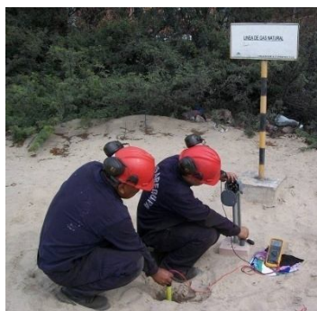
ACEROS AREQUIPA: Instantes de toma de potencial en poste N° 1 del sistema de protección catódica del ducto de gas natural de Aceros Arequipa. Febrero 2011
