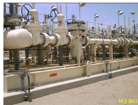
PLANTA PAMPA MELCHORITA: Vista general de la estación de medición de gas entrante a la Planta. Se observa al paquete L-1001, dentro del cual se encuentran tres filtros, los mismos que fueron inspeccionados visualmente así como sometidos a una medición de espesores con ultrasonido. Febrero 2011.
