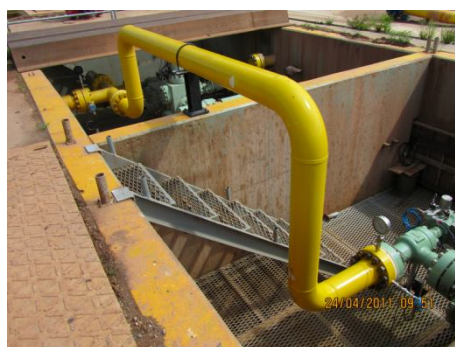
Plataforma Pagoreni A: Vista del spool que une las producciones de los pozos 1006 y el último perforado 1007. Se observa los medidores de presión y transmisores de temperatura. Abril 2011.
