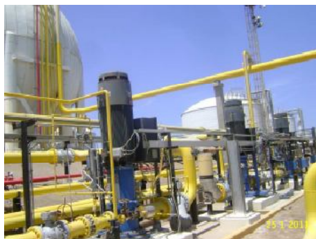
PLANTA PISCO: Vista de bomba de propano al tanque de almacenamiento. Se encuentra bien pintada, cuenta con placa de identificación y no presenta fugas ni ruidos anormales. Cuenta con
