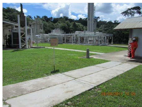
PLANTA CURIMANA: La distancia de Sala de Control al equipo mas cercano (generador 28-9601B), es 15.9m. Abril 2011.
