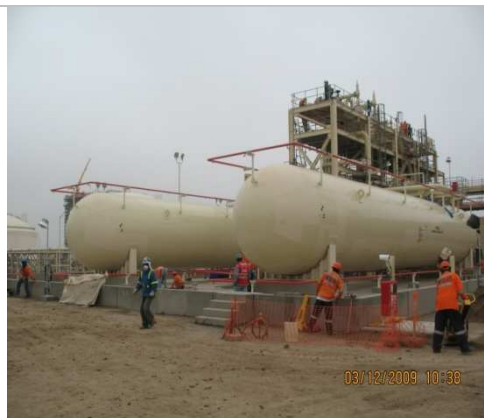
PLANTA MELCHORITA: Tanque de almacenamiento de refrigerantes.
