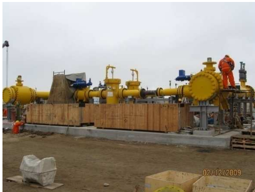
Instalaciones del patín de regulación – medición.
