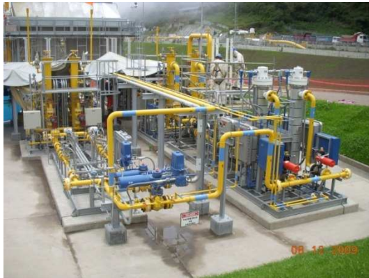
Sistema de Medición y Regulación, Skid de filtración, medición y regulación de gas
