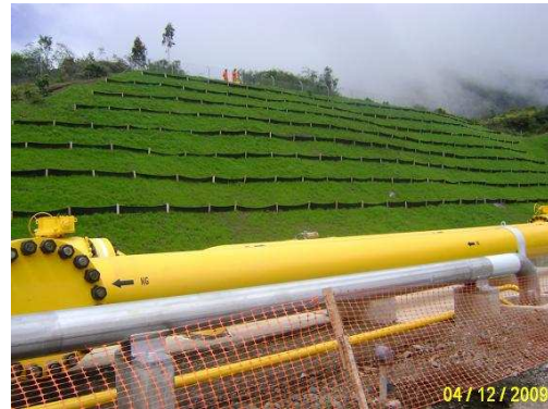
Talud Sur totalmente revegetado, sus defensas temporales "trinchos" serán retiradas.
