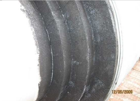
PLANTA MELCHORITA: Aislamiento con tres capas de bloques de celular glass para tubería de transferencia a -160^{\circ}\text{C}
