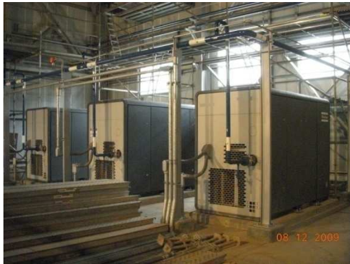
Compresores C-3210 A/B/C. Los Compresores A/B se encuentran comisionados
