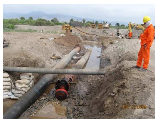
Llegada del chanco de limpieza tras ser lanzado en el Kp. 670. No se observan daños en su estructura.
