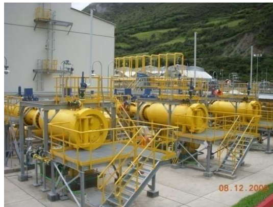
Sistema de Filtración. Equipos principales: Filtros F-3101-A/B/C.
