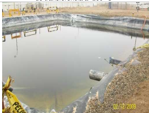
PLANTA MELCHORITA: Ósmosis Inversa – CB&I; vista que muestra el reservorio RES-25 donde se almacenan los efluentes tratados producto de las Plantas de Tratamiento de aguas residuales.
