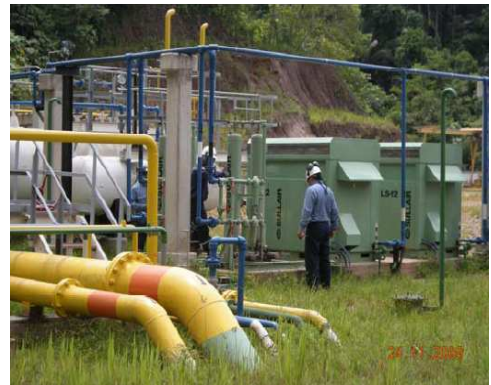
Plataforma Pagoreni B: Vista al personal haciendo los mantenimientos preventivos de los pulsadores de la válvula de bloqueo del sistema de producción
