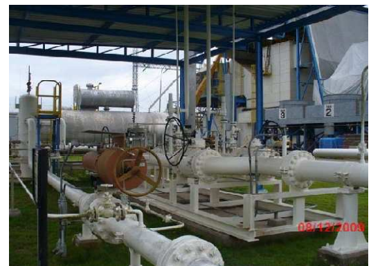
Lote 31C: Instalaciones de medición del lado de la Central Térmica de Aguaytia.
