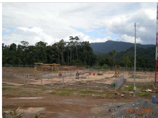
Plataforma Cashiriari 1: Vista de la plataforma de producción de los pozos en Cashiriari 1.
