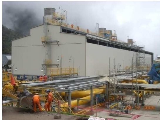
Turbina GT-3101-A/B/C/D y Compresor C-3101-A/B/C/D. Los Turbocompresores A/B se encuentran comisionados.
