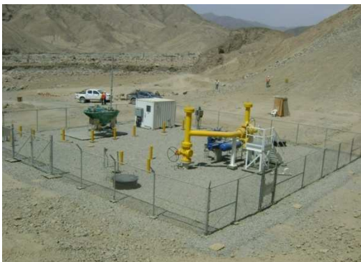
KP 309+540: Instalaciones de la Válvula N° 10
