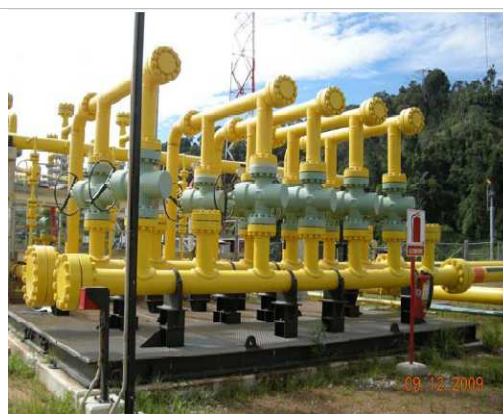
Plataforma Cashiriari 1: Vista del Manifold de producción en donde se junta la producción de los cinco pozos, ubicados en Cashiriari 1 y van hacia Malvinas.
