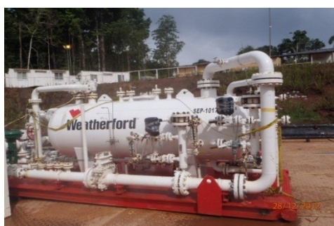
Equipo de la empresa de Weatherford utilizado para la prueba de Testing
