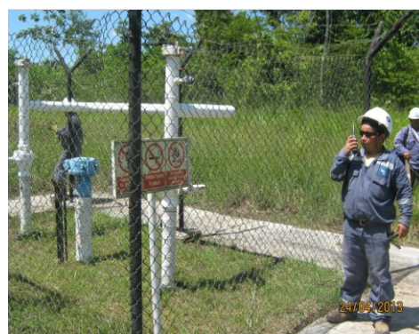
Válvula MV-A-03 del KP 88: Vista de la verificación del cumplimiento del tema "Comunicaciones" de la DJ de Criticidad Baja de Enero 2013.
