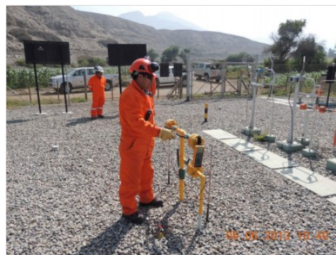
Vista de una toma de potenciales en la PRS2.
