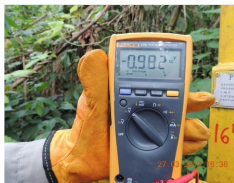
Vista de una toma de medición de -982 mV, el cual se encuentra dentro del rango normal de -800 a -1200 mV de la norma NACE.
