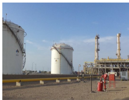
TANQUE DE ALMACENAMIENTO DE CONDENSADO TKJB-23000.
