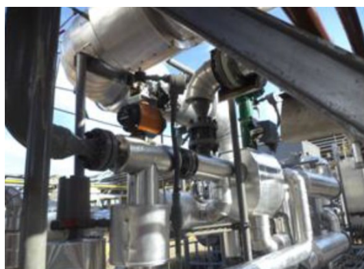
VÁLVULA DE CHECK INVERTIDA EN LÍNEA DE LUBRICACIÓN DE COMPRESOR KBA-24060.
