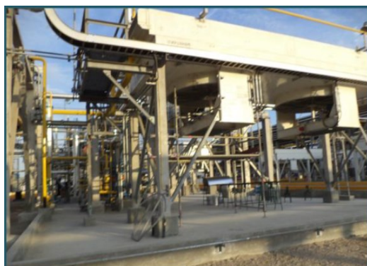
UNIDAD DE RECUPERACIÓN DE VAPORES
