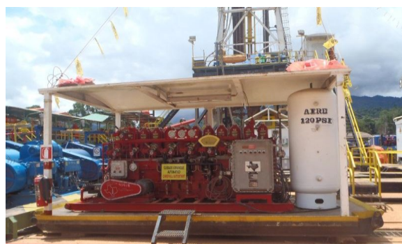
Acumulador del BOP
