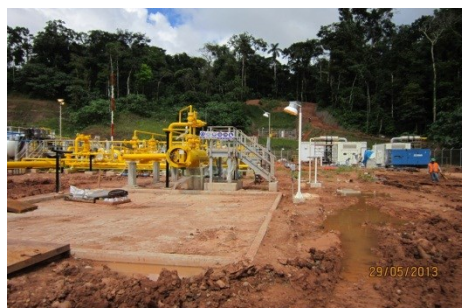
Pluspetrol: Vista de la zona de lanzamiento de raspatubos en Mipaya.
