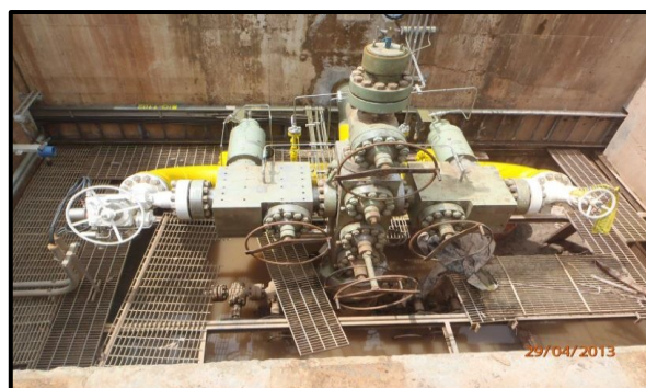
Pozo que cuentan con 2 válvulas choke o válvulas de cabeza de pozo (XCV) una manual y otra automática que regulan el caudal del pozo. Válvula identificada de color blanco
