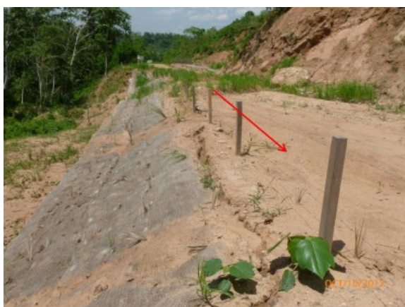
KP 26+760 del ducto Neshuya – CTA Presencia de grietas en el límite del terreno firme y el de relleno donde el DdV colapso por erosión. (Las obras de geotecnia han estabilizado este Tramo)
