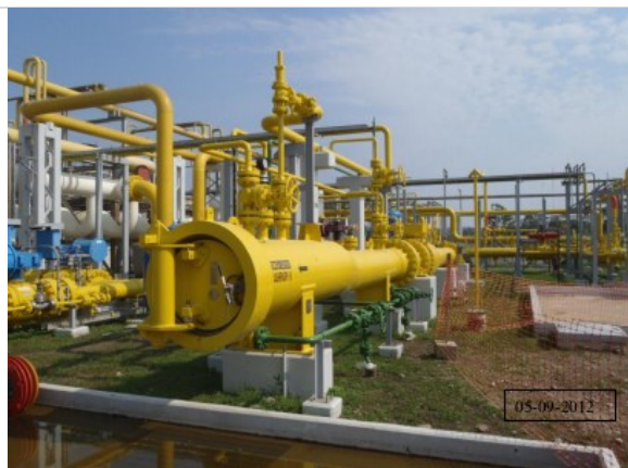
Vista de la trampa de raspapubo del flowline Cashiriari 1.
