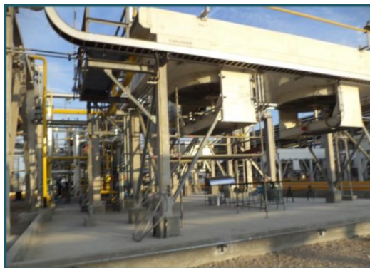
UNIDAD DE RECUPERACIÓN DE VAPORES
