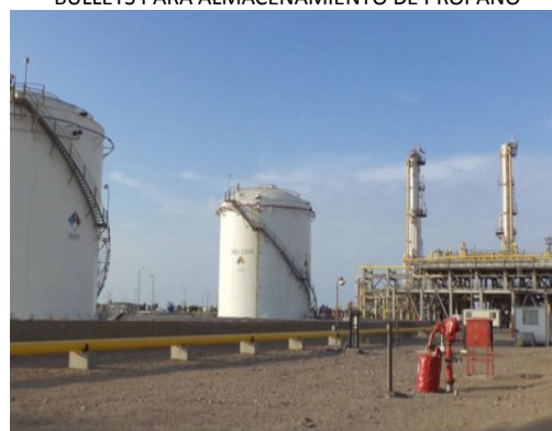
TANQUE DE ALMACENAMIENTO DE CONDENSADO TKJB-23000.
