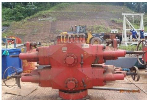
BOP del equipo de perforación, se observa el RAM doble
