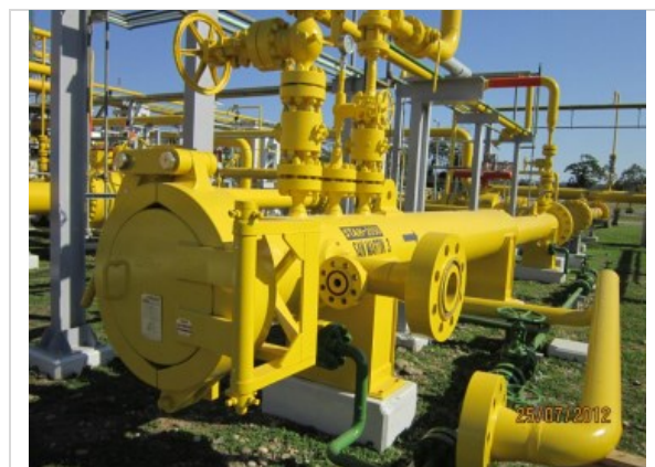
Vista de la trampa de lanzamientos de raspapubos del flowline de reinyección de gas para el cluster de San Martín 3
