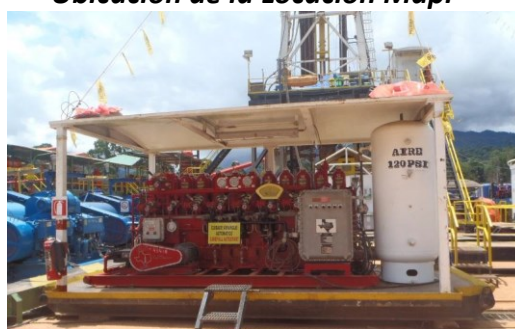
. Acumulador del BOP
