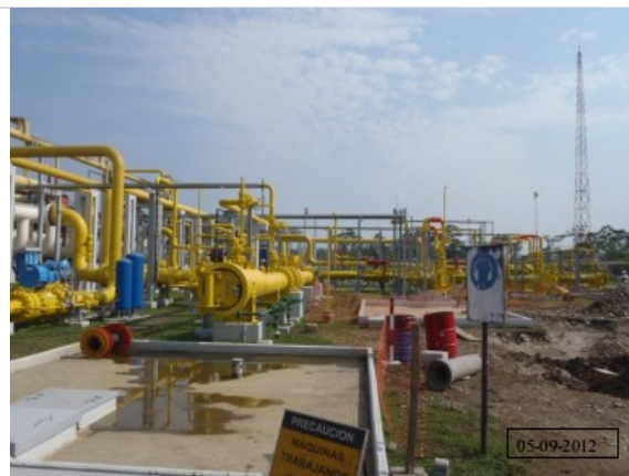
Vista de la llegada de los flowlines a la Planta Malvinas (Pagoreni A, Cashiriari 1-3 y San Martín 1- 3).
